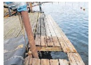
Das Holz gammelt, die Erneuerung ist unbedingt notwendig.
